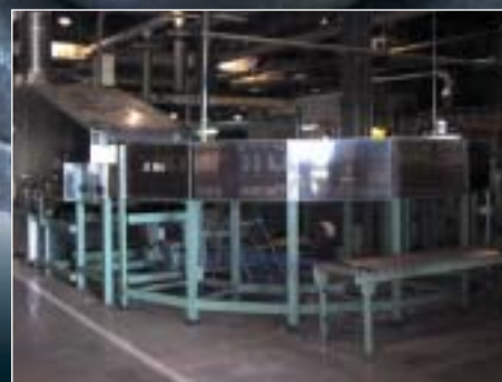
Tsubaki's automatische smeerinstallatie
